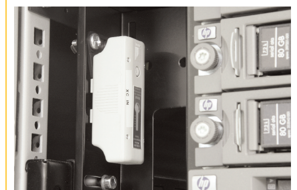
FIGURA 3: Sistema de monitorización
